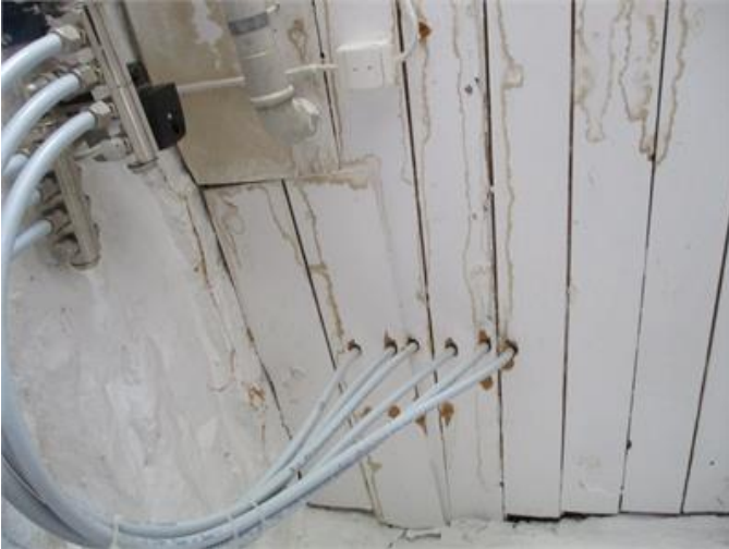
Bild visar missfärgningar i källartak
