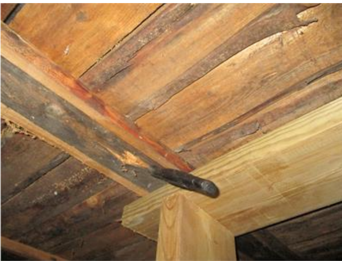
Röta i golvbjälke samt förstärkt bjälklag
