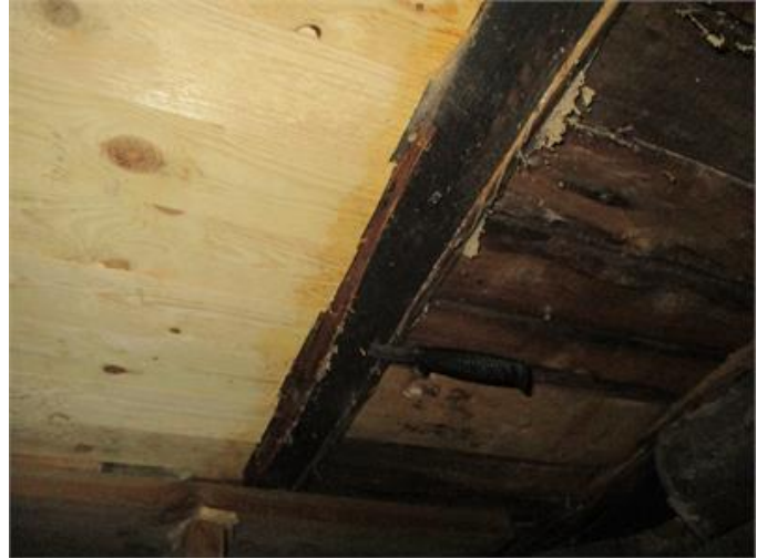
Röta i golvbjälklar samt utbytta brädor i blindbotten
