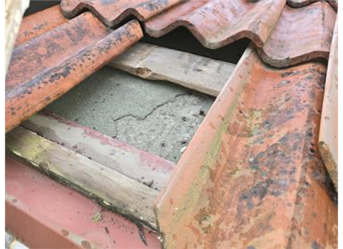
Bilden visar exempel på underlagstak i dåligt skick.
