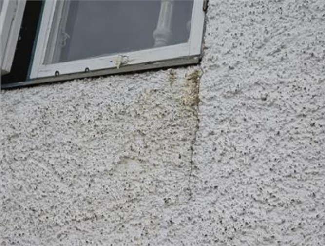
Exempel på spricka i fasaden.
