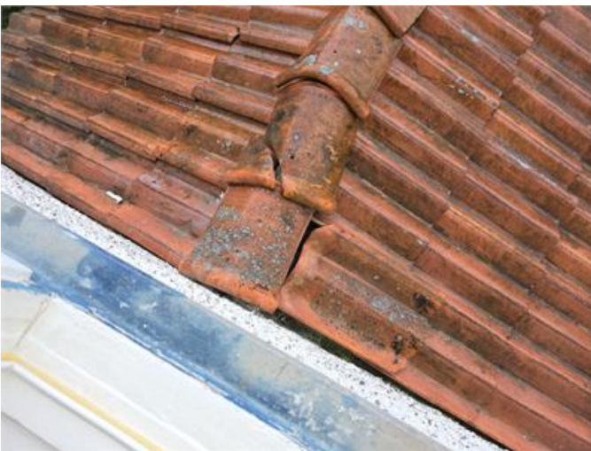
Exempel på sprucken takpanna och otätheter vid nock på lågdal.
