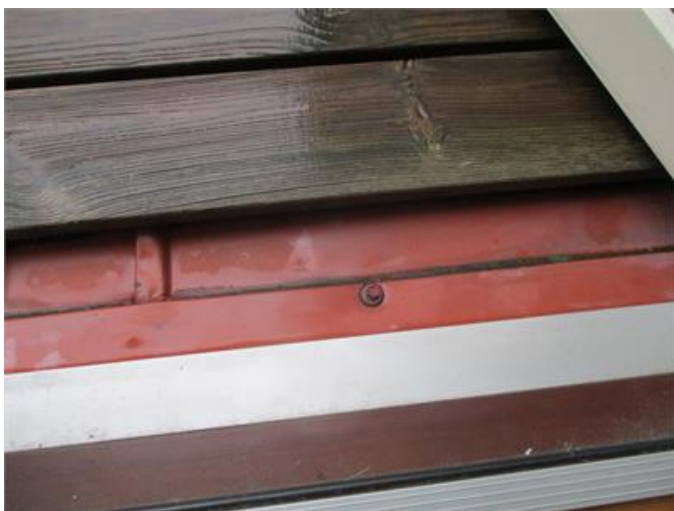
Bild visar en skruv i takplåten framför balkongdörr
