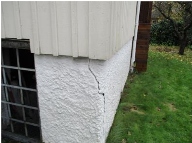
Exempel på sprickor i sockel
